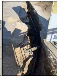
Fotografia 05 Sanejament en alta de la guingueta i corrugat amb línies elèctriques. Caldrà comprovar si en servei.
