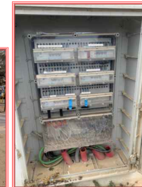
Fotografia 14 Armari ajuntament amb enllumenat, pilones connexió passeig, escenari sardanes.
