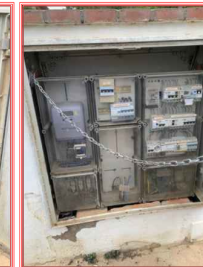
Fotografia 15 Armari ajuntament amb àrea activa, enllumenat, escomesa i comptador.
