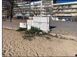
Fotografia 03 Quadre companyia Endesa, comptadors elèctrics i quadre Ajuntament.
